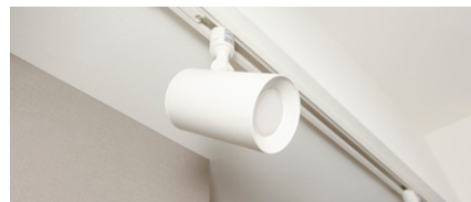
ライティングレール
