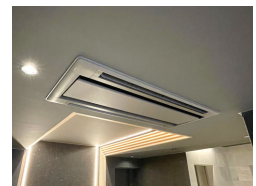
冷暖房付エントランス
