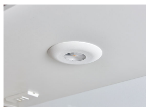
コンセント & ダウンライト ※一部タイプのみ
